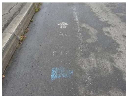
写真 見えにくくなった路面表示
